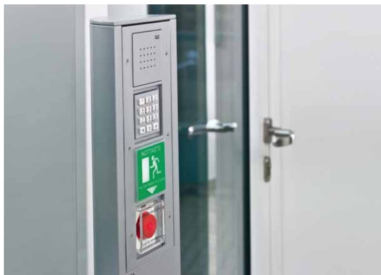
TMS Protection des issues de secours
